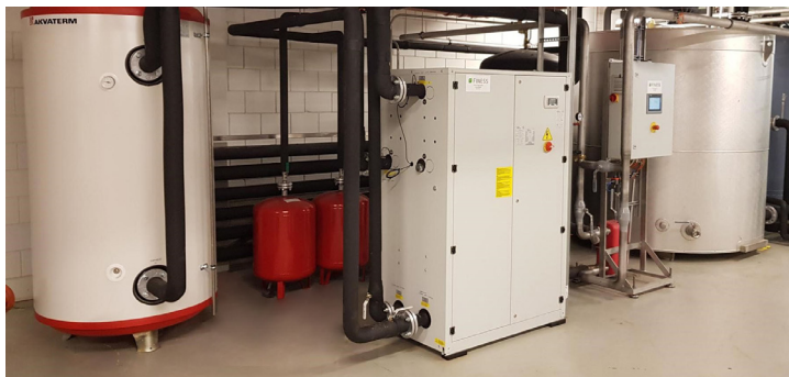
Jäteveden LTO-laitteisto teollisuuskohteessa.
